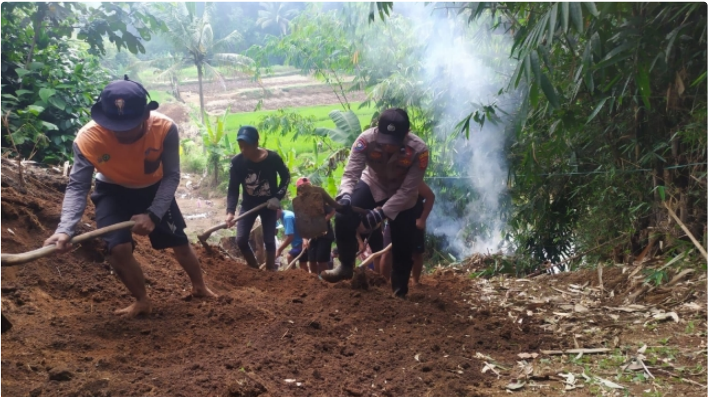
Belum Punya Akses Jalan, Bhabinkamtibmas dan Babinsa Beserta Warga Kerja Bakti Perbaiki Akses Jalan
